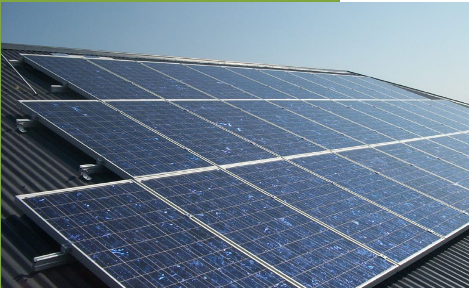
Instalación con estructura integrada* de paneles solares de tipo policristalino**
